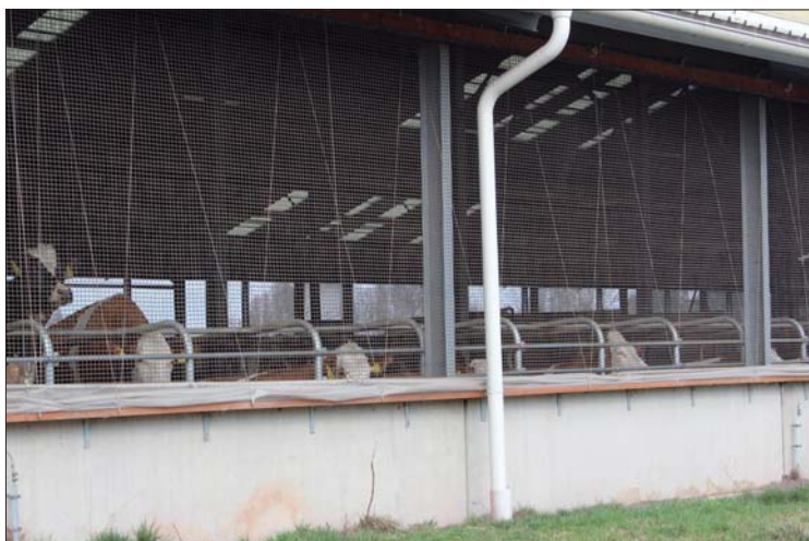
Boční stěny stáje tvoří protiprůvanové sítě s roletami
